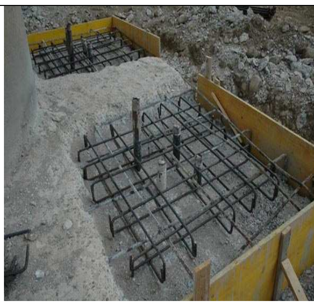
b) – Aggiunta posticcia di ferro
